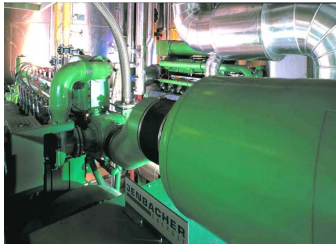
Cogeneración de calor/electricidad – motor de gas
