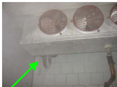
Capa de hielo en el evaporador
