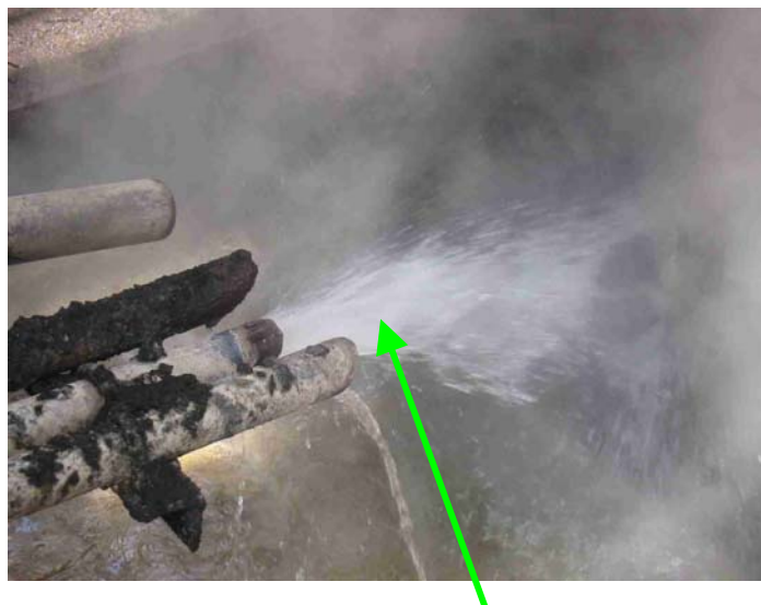
Condensado caliente hacia un sistema de drenaje con 98°C
